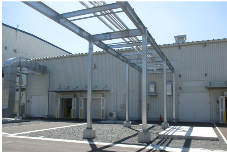
【濾過工程外観】
