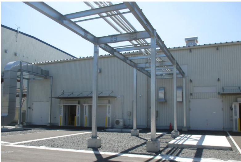
【濾過工程外観】
